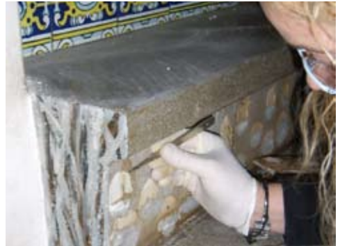
Pruebas de eliminación de añadidos en una contrahuella de la escalera. © DHUB. Fotografía de Rossend Casanova
