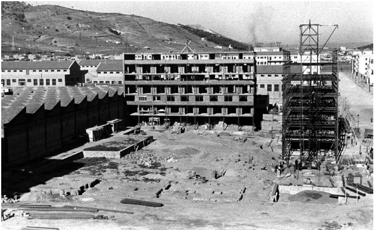
Figura 1. Construcción por bloques del edificio mediante una estructura metálica y cerramientos cerámicos. La fábrica de curtidos de la izquierda, junto a las demás, muestra el entorno fabril donde se levantó la Casa Bloc. El esqueleto de la derecha corresponde al segundo bloque, en cuyo extremo se encuentra el piso-museo. © Margaret Michaelis, 1934. Arxiu Fotogràfic de Barcelona.
